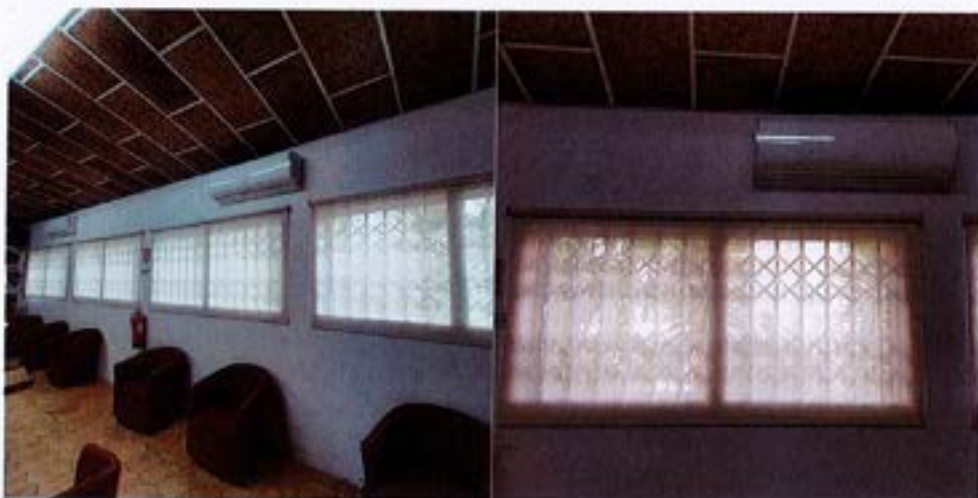
Foto nº 13 – Ar condicionado e estores instalados no CD
